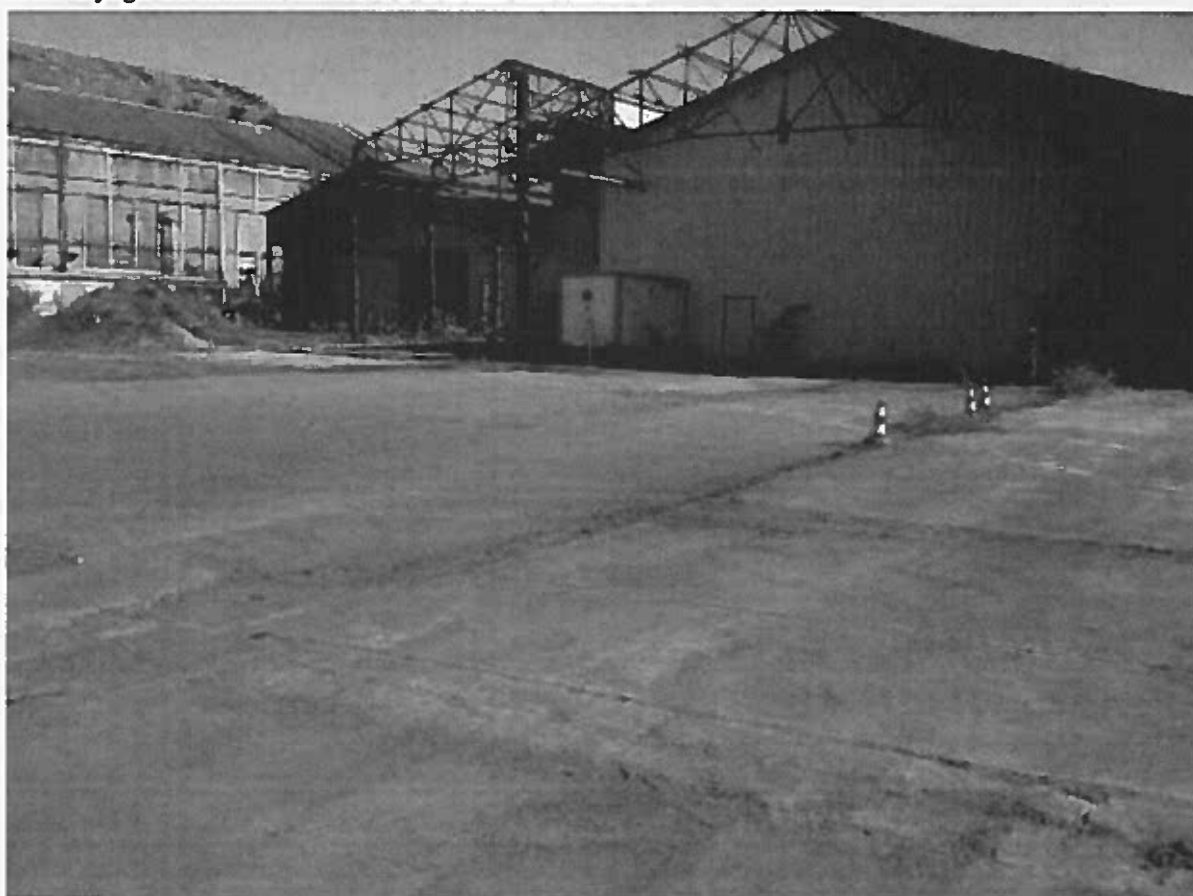
FIGURE 13 : ETAT DE LA DALLE APRES NETTOYAGE
